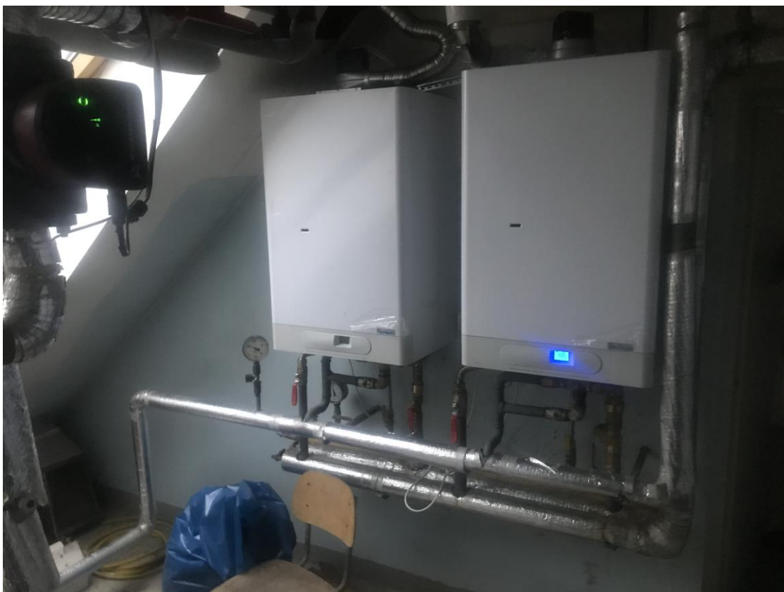
Obrázek 5. Poslušného 7 – 2 nové kotle vč. rozvodů, původní malý kotel, vyměněn za větší
