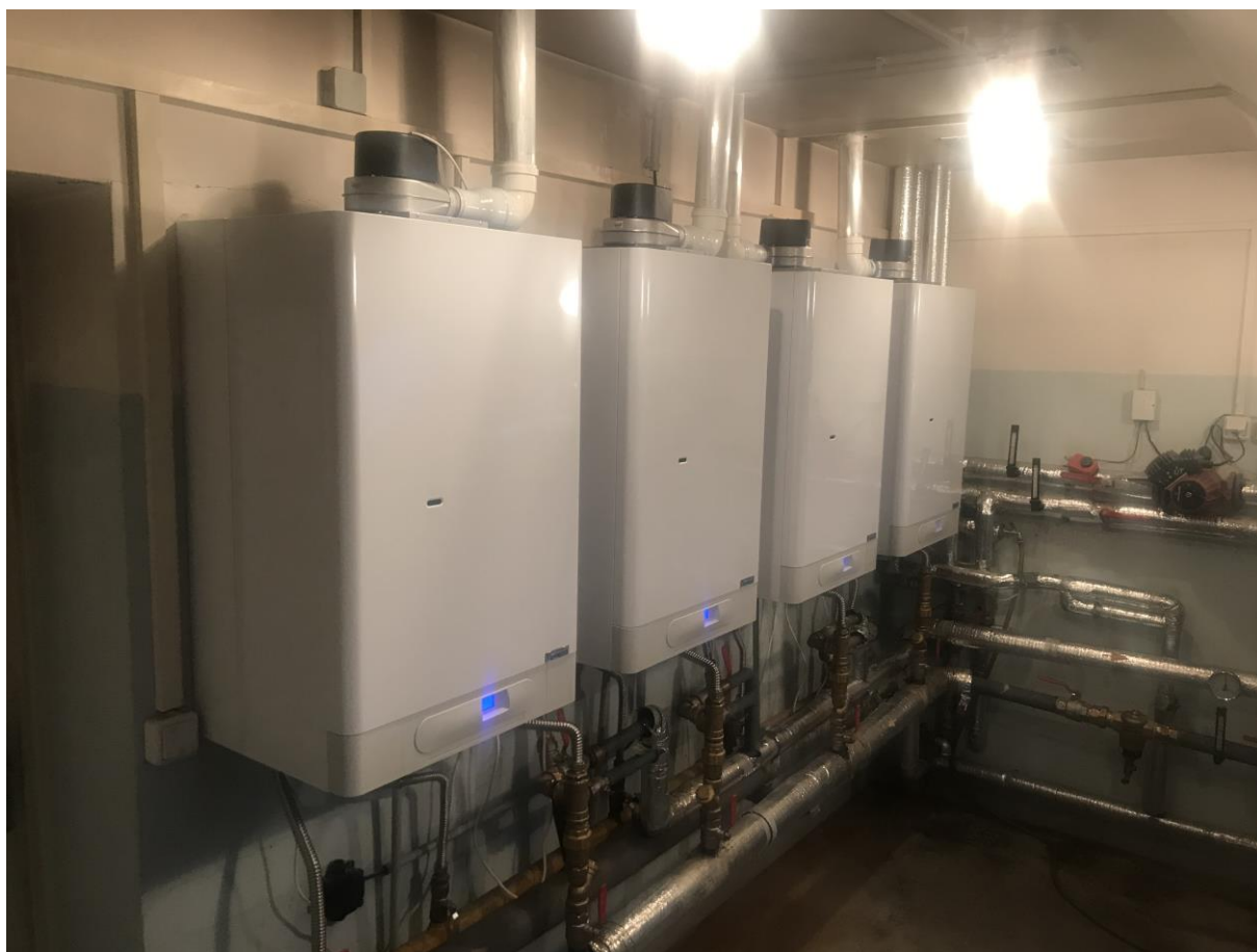
Obrázek 1. Poslušného 5 - 4 nové kotle - v provozu všechny
